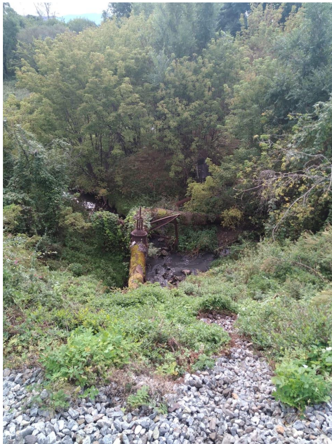
Рис.5 Вид с откоса. Наземные трубы теплосети с водопроводом.
