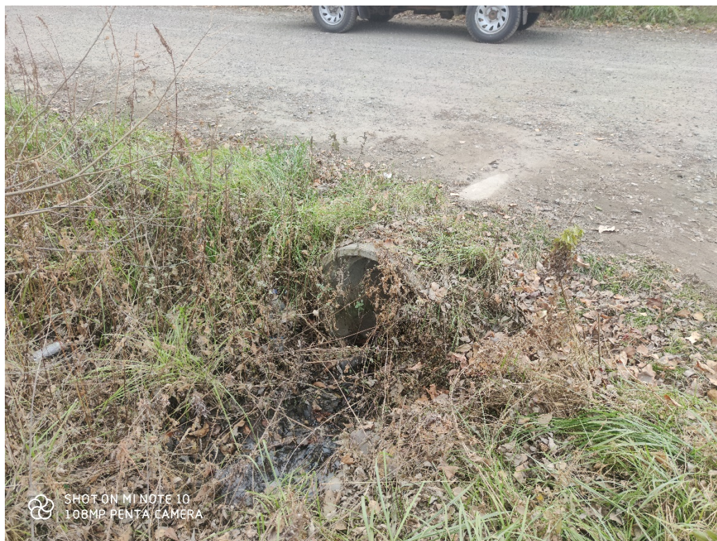
Рис.24 Труба ж/б через улицу Театральная
