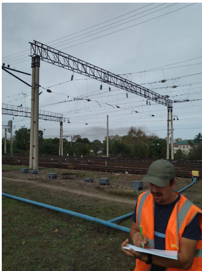
Рис.8 Воздухопровод на ж/ путях
